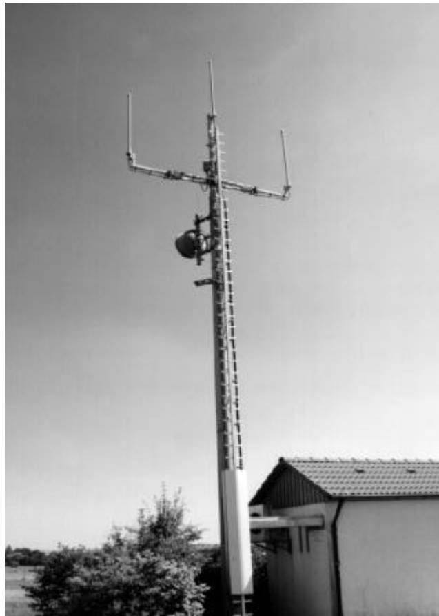
Abb. 2: Sendemast einer Mobilfunkbasisstation.
